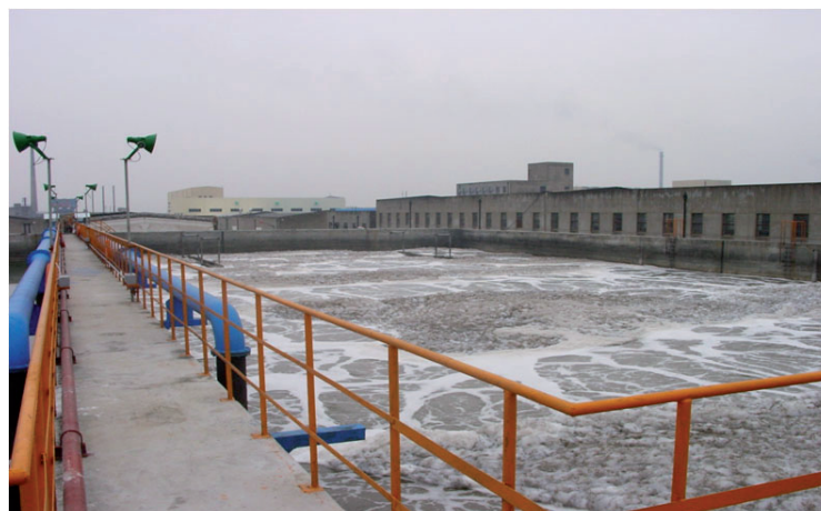
(SBR) Reactor Secuencial Intermitente
