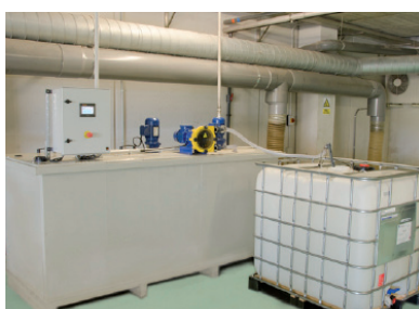
Central de preparación Automática en continuo de polielectrolito
